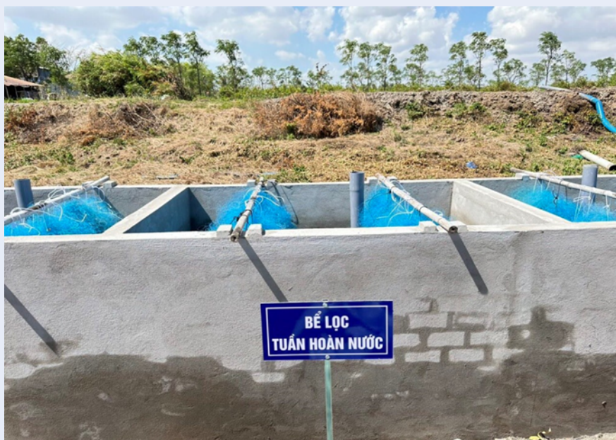
Hình 3: Bể lọc tuần hoàn nước. [Nguồn: Nhóm tác giả]
